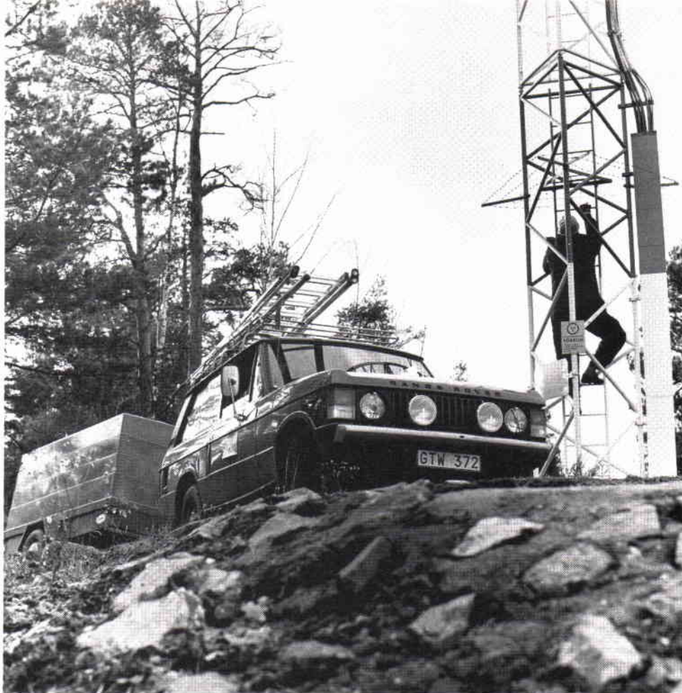
Antennmätfordonet på plats. "Vägen" var inte alltför besvärlig eftersom släpet med elverk hängt med ända fram.
